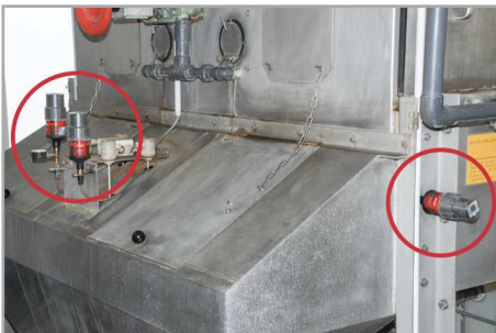
Schlammverdickung: Lagerschmierung an der Überschussschlammverdickung
