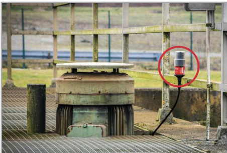
Belebungsbecken: Lagerschmierung zur Belüftung des Beckens
