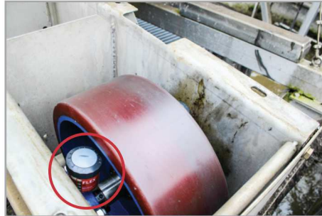
Sand- und Fettfang: Flanschlagerschmierung am Längsräumer
