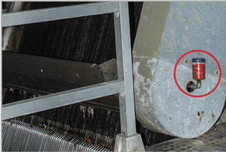
Grobrechen: Schmierung an der Kettenumlenkrolle
