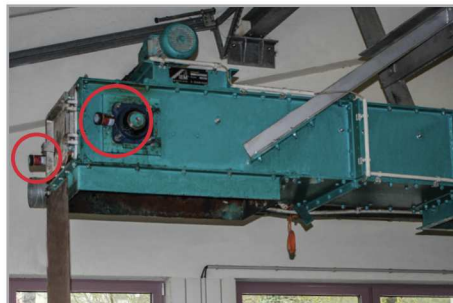
Schlammtransportband: Flanschlager am Schlammtransportband
