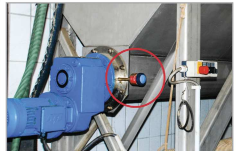
Schlammverdickung: Lagerschmierung der Schneckenpresse
