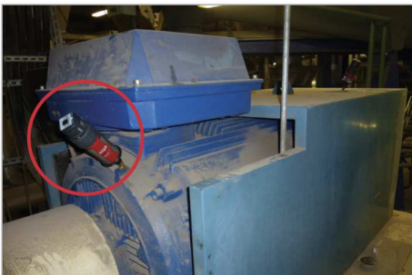
Motorschmierung einer Pumpe
