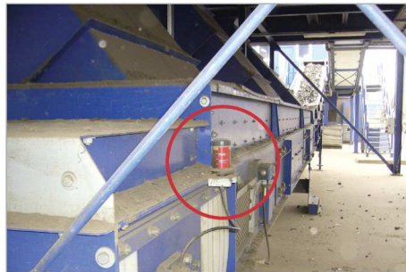
Stehlagerschmierung einer Förderbandanlage
