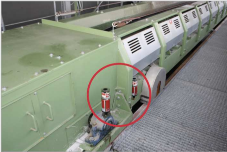
Stehlagerschmierung einer Förderbandanlage
