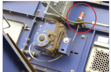
Flanschlagerschmierung einer Förderbandanlage
