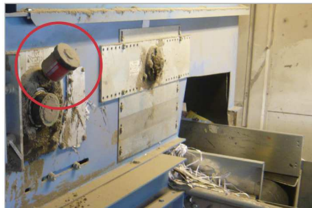
Flanschlagerschmierung einer Förderbandanlage
