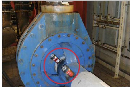
Antriebswellenschmierung einer Pumpe
