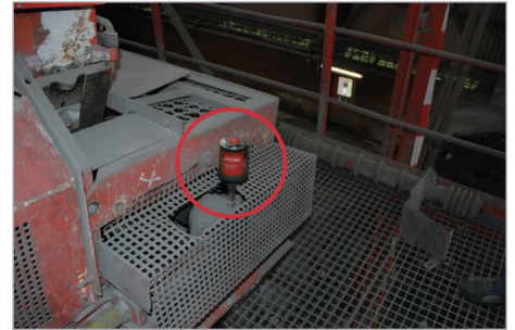
Stehlagerschmierung einer Förderbandanlage
