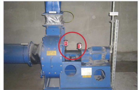
Antriebswellenschmierung einer Lüfteranlage
