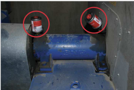
Stehlagerschmierung einer Lüfteranlage
