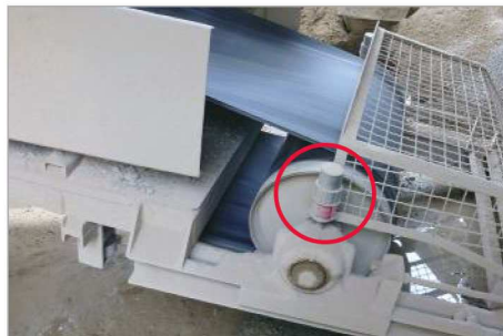
Stehlagerschmierung einer Förderbandanlage
