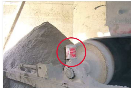
Stehlagerschmierung der Umlenktrummel
