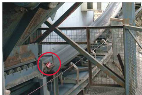
Stehlagerschmierung einer Bandwaage
