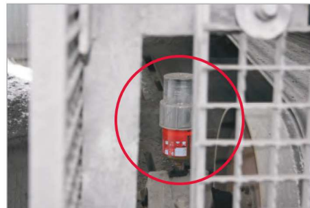
Stehlagerschmierung einer Umlenktrummel
