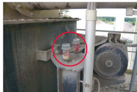
Stehlagerschmierung einer Förderbandanlage
