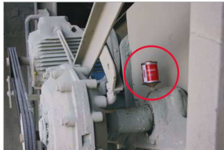
Stehlagerschmierung der Antriebstrommel
