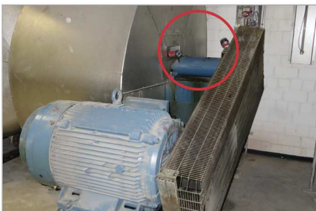
Schmierung der Lagerungseinheit am Lüfter
