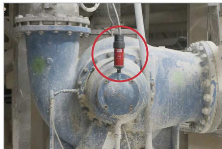
Lagerschmierung der Pumpe
